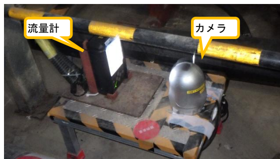
(写真2) 流量計の監視状況
