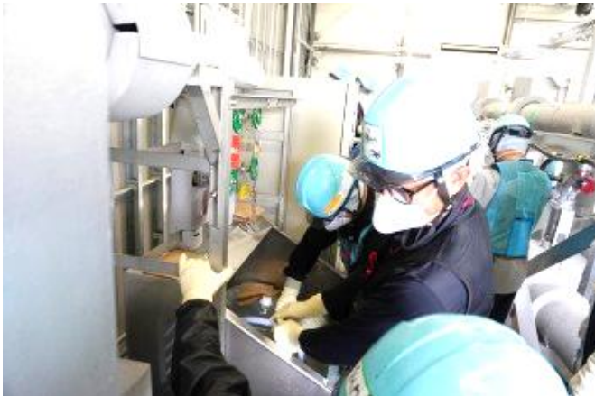
▼多核種移送設備建屋にてALPS処理水を採取している様子
