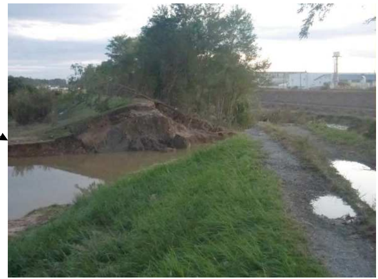
出典: 令和元年台風19号災害の概要 福島県県中建設事務所 谷田川破堤箇所(2.5km左岸)
