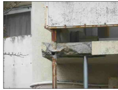
バルコニー劣化状況
