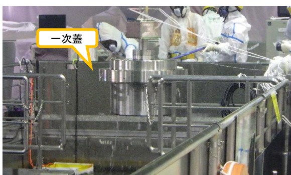
(写真 15) 取り外された一次蓋
