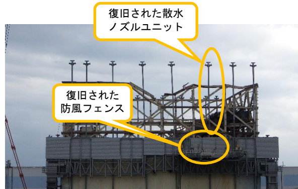
(写真2) 西面の防風フェンス及び散水ノズルユニットの復旧状況
