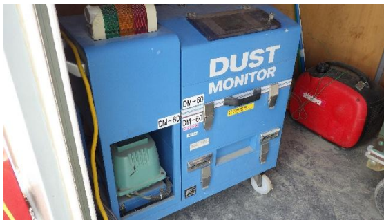
(写真3①) ダストモニタの設置状況
