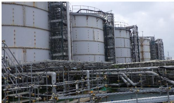
(写真 1－3) 雨水受入タンク及び処理水タンク
