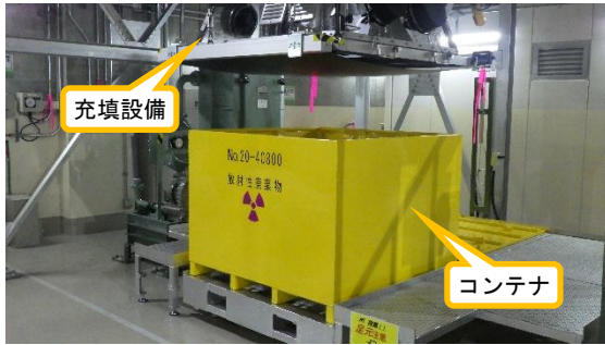
(写真 6) 焼却灰をコンテナに充填する設備の 状況
