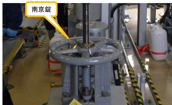
（写真２）弁操作後の施錠状況
