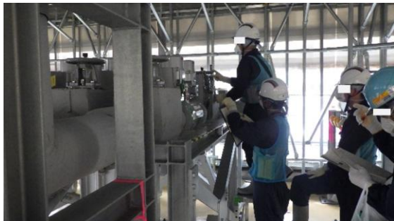
(写真1－1) 指差呼称による弁の開閉確認の状況
