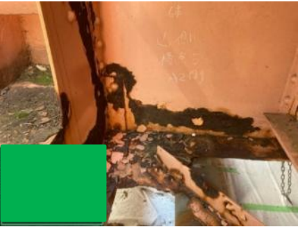
補修前（桁腐食状況）
