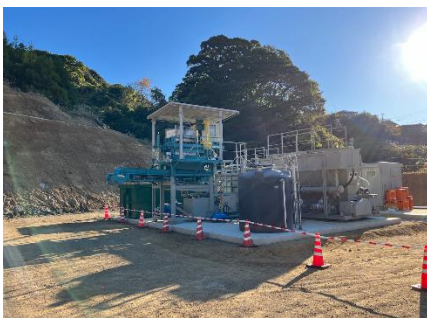
濁水処理設備外観
