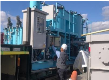
保守点検状況
