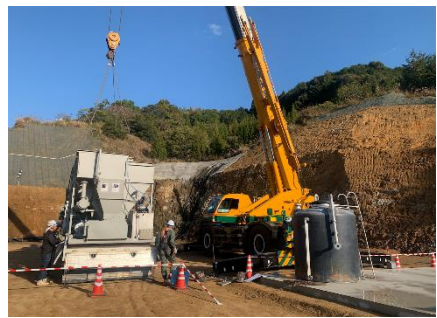
濁水処理設備設置状況
