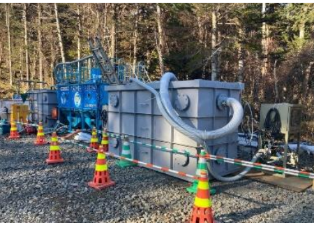
濁水処理設備外観
