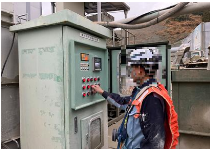
保守点検状況
