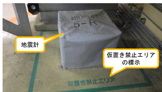
(写真2) 地震計（地上2階）の設置状況
