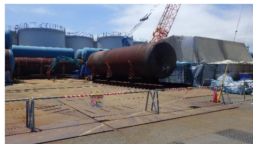
(写真 3 ②) ブルートankの保管状況②
