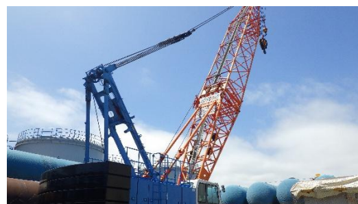
(写真 4 ②) 重機の保管状況②
