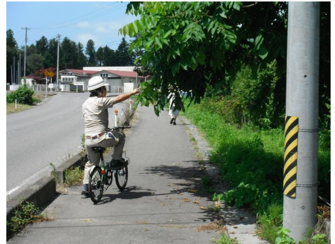
道路路肩の崩壊
