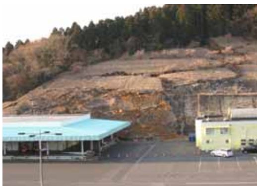
(崩落した、冷蔵施設(左)とバナナ加工所施設(右)の背後法面)
