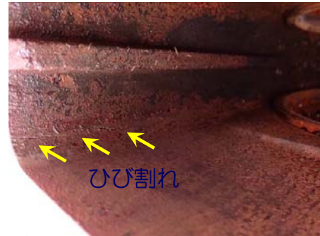
錆拭き取り後
