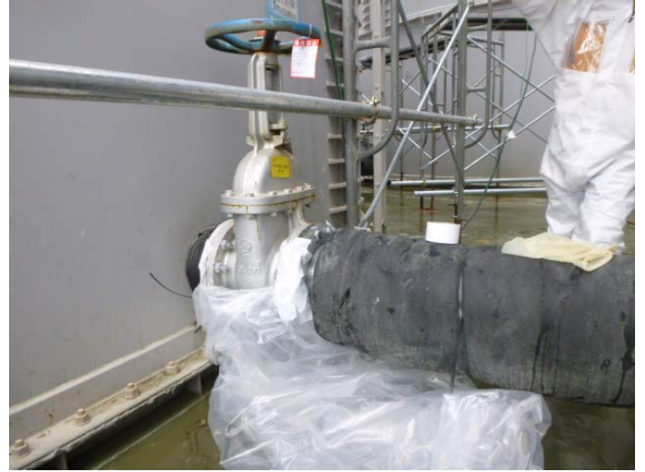
漏えい後の養生状況
