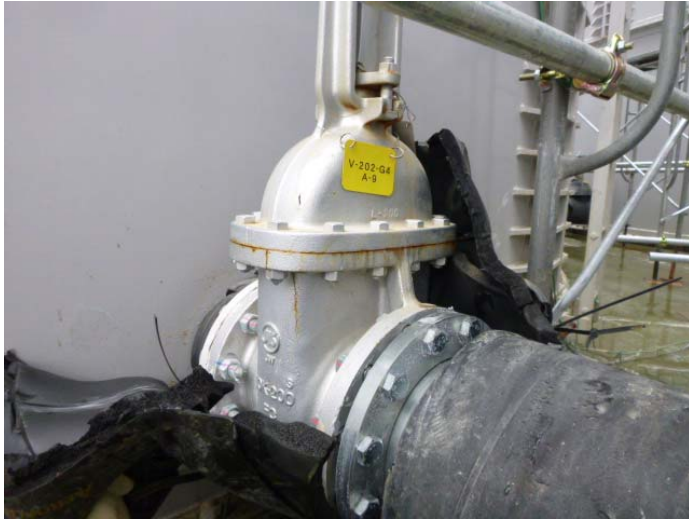
漏えいした弁（閉状態）
