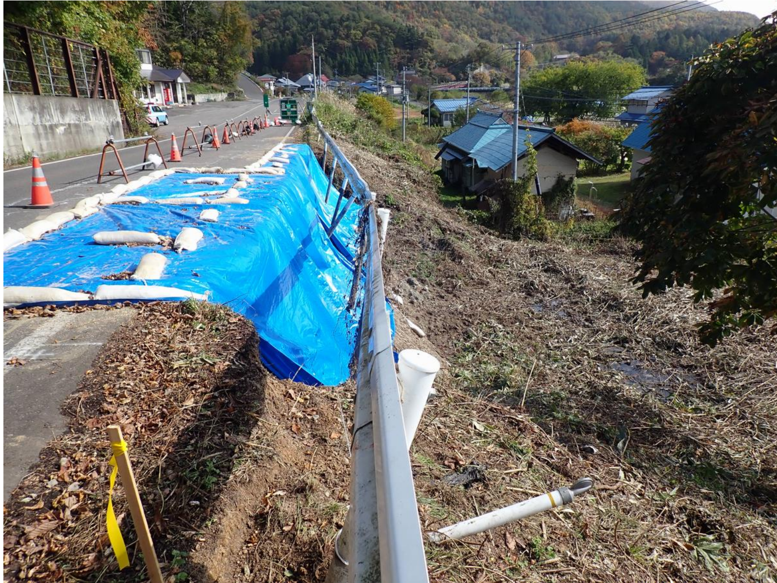
国道118号 路肩崩壊 (天栄村大字田良尾地区)
