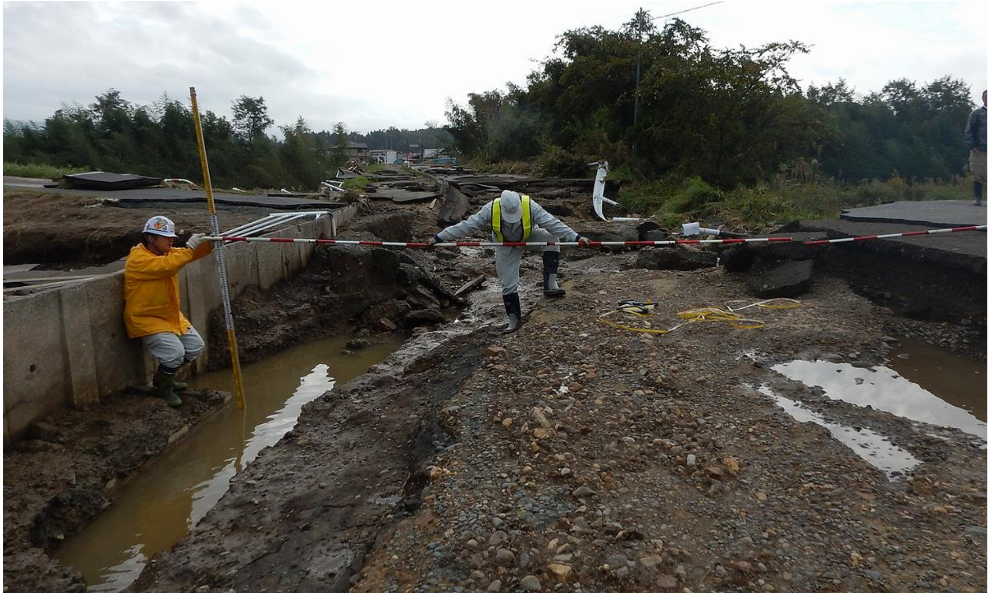
県道母畑須賀川線 道路崩壊（須賀川市和田地区）
