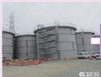
フランジ型タンク
