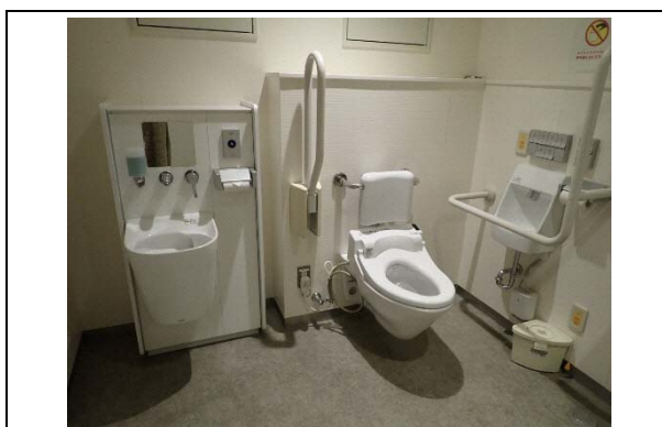
オストメイト対応トイレ（福島県庁西庁舎）
