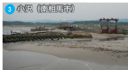
堤防の決壊・樋門の損壊
