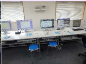
ダム管理システムの整備
