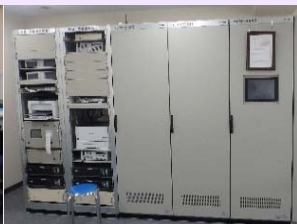
地震・堤体挙動の観測装置
